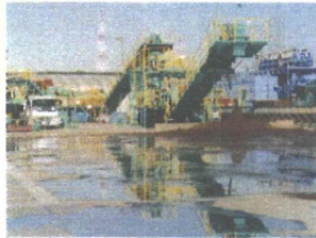
油汚染土壌洗浄プラント
