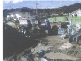
微細砂含有畑砂洗浄プラント
