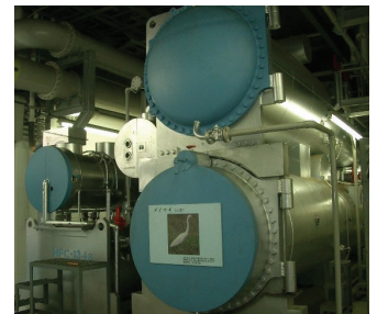
下水熱利用ヒートポンプ
