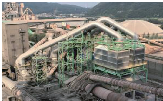
セメント排熱発電設備 (韓国 Ssangyong Cement)
