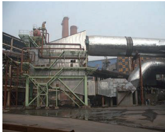
焼結クーラー排熱設備 (中国武漢鋼鉄)
