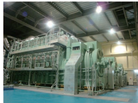
日本テクノ発電機室内
