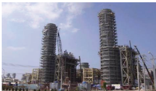
フーミー 2-2 排熱回収ボイラ
