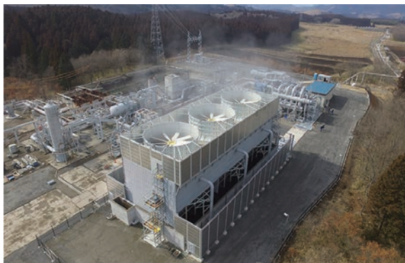
滝上バイナリー発電所（日本） 出力：5.05MW、2017年運転開始
